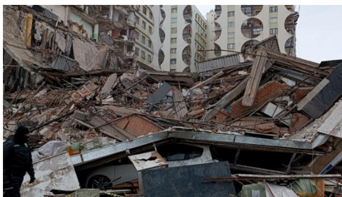
Рисунок 1 – Разрушения в результате землетрясения в Турции
